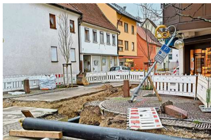
Die Laterne wurde umgeknickt.
